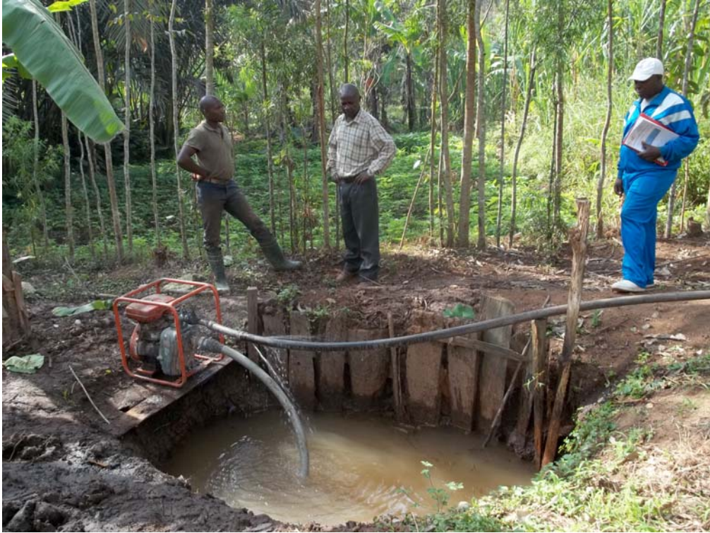
PUIT EAU ET MOTOPOMPE
